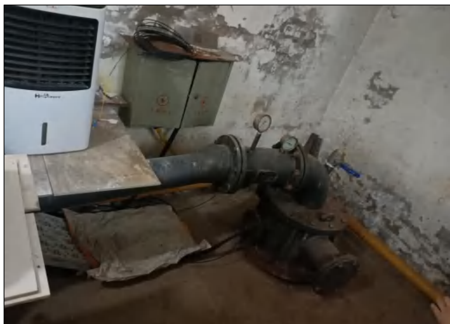
照片1.3-2 R6井室内井口
