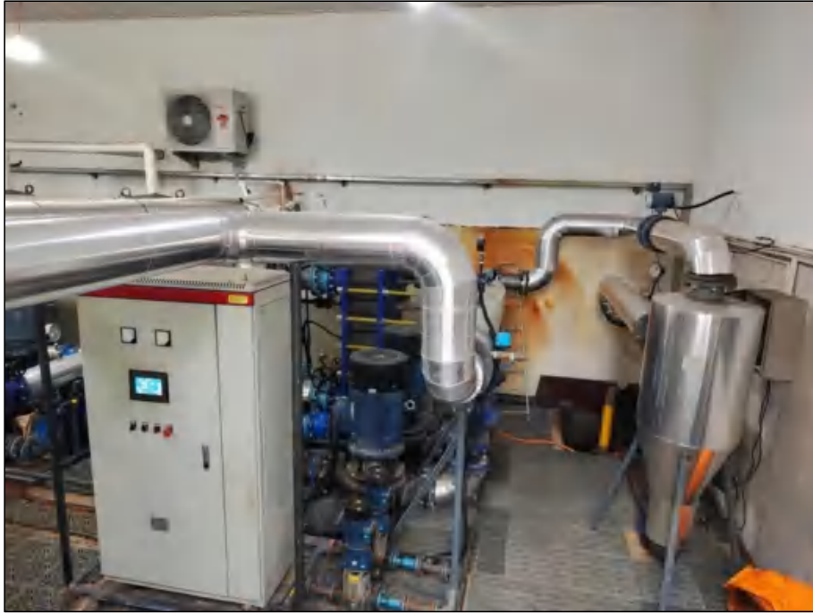
照片1.3-3 R6井室内开采管道及设备
