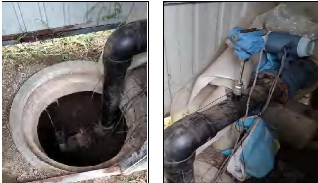
照片3.3-7 R1井室内井口及监测设备
