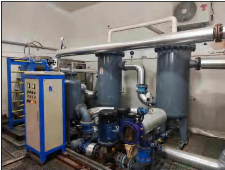
照片1.3-4 R6井室内回灌管道及设备
