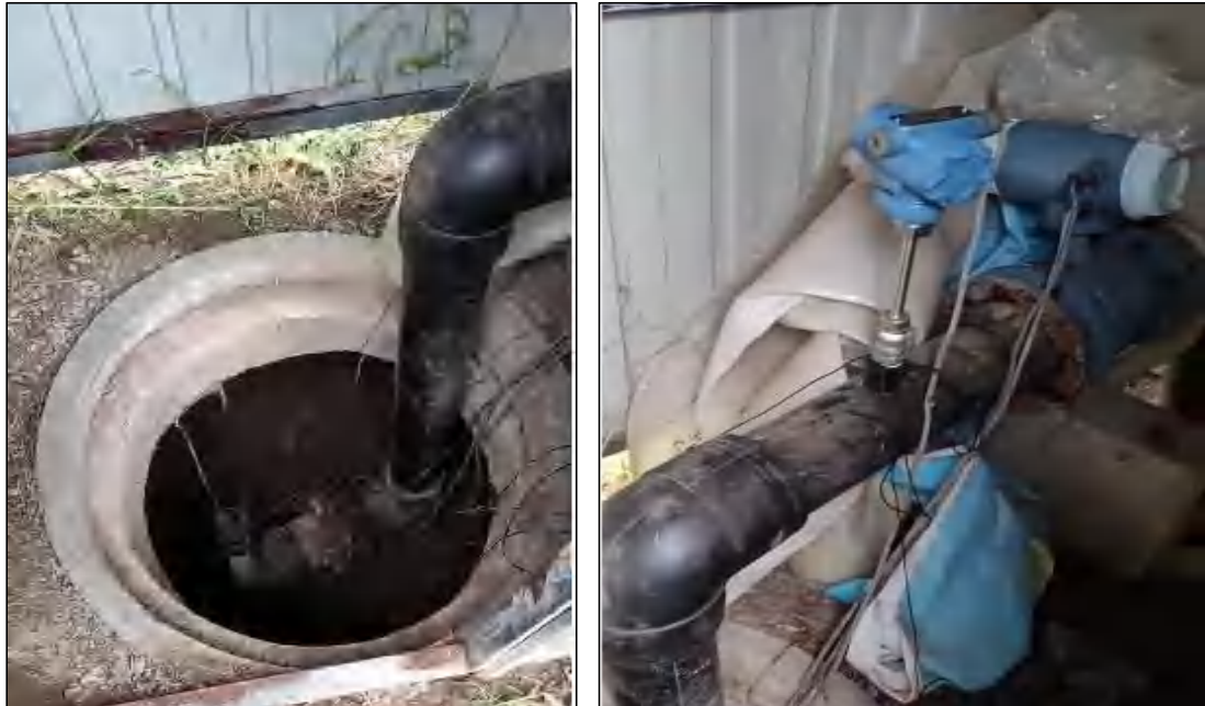
照片1.3-6 R1井室内井口及监测设备
